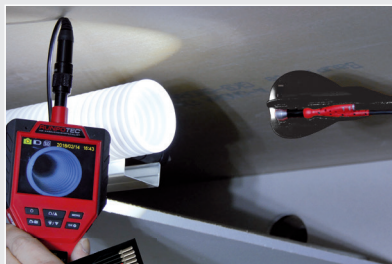
Lüftung- und Wartungsinspektion
